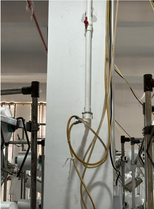
车间洒水系统
