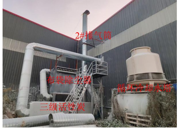
布袋除尘+三级活性炭装置
