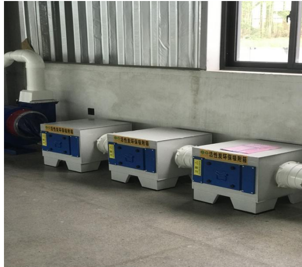
三级活性炭吸附装置（打胶废气处理）
