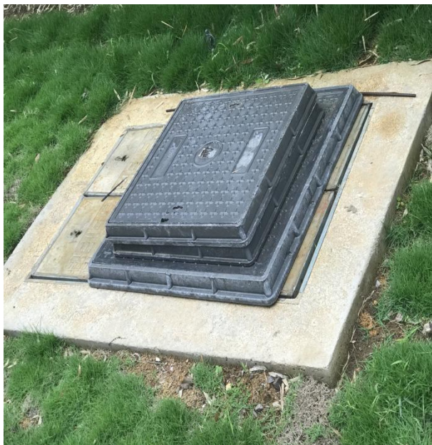
初期雨水池（地下）
