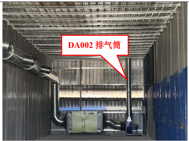
三级活性炭+DA002 排气筒排放 (涂装车间废气处理措施)
